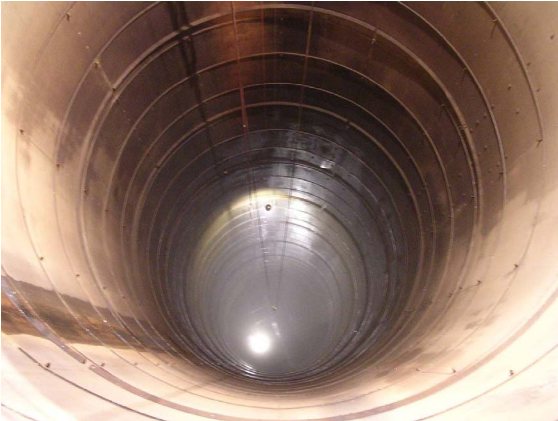
Foto pozzo piezometrico Verbano
